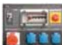
Generator-Tableau: Die auf Wunsch mit einer Klappe verschließbare Schaltzentrale verfügt über einen abschließbaren Hauptschalter und spritzwassergeschützte Steckdosen der Schutzklasse IP44. Die Schutztrennung mit Isolationsüberwachung erbringt die Erdung.
